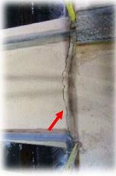
【コンクリートのひび割れ】
