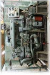
【予備動力ポンプ(50年経過)】
