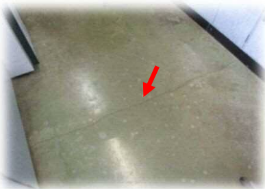
■床のクラック（試験室）■
