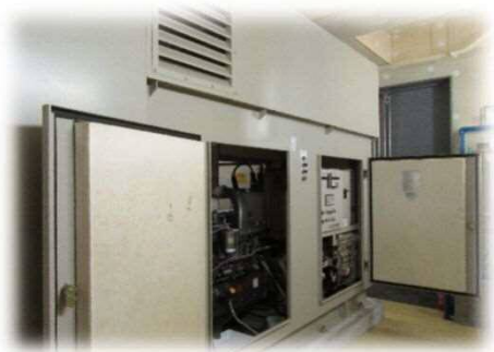
■自家発電設備（西芦別浄水場）■
