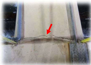
■コンクリートのクラック（ろ過池）■
