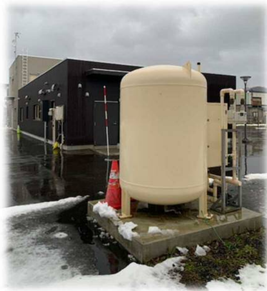
[指定避難所のLP ガス供給ガスバルクシステム]
