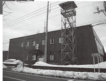
老朽化し手狭な現在の消防庁舎
