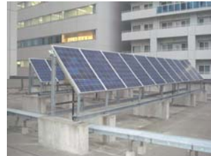
太陽光発電システム導入例 (札幌市環境プラザ)
