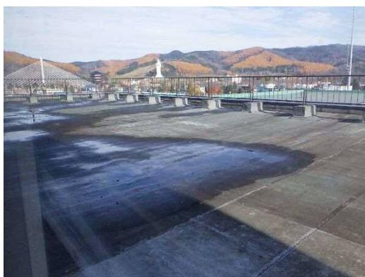
雨水が溜まる屋上防水
