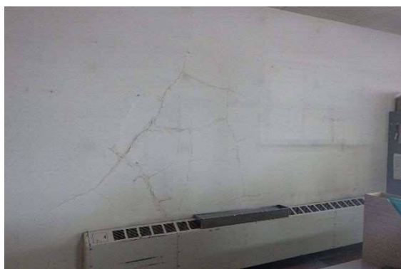
壁のクラック
