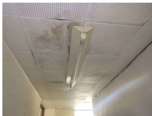
天井雨漏り跡
