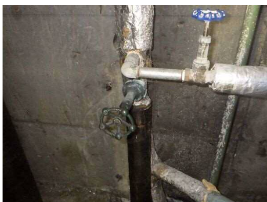
給排水管の老朽
