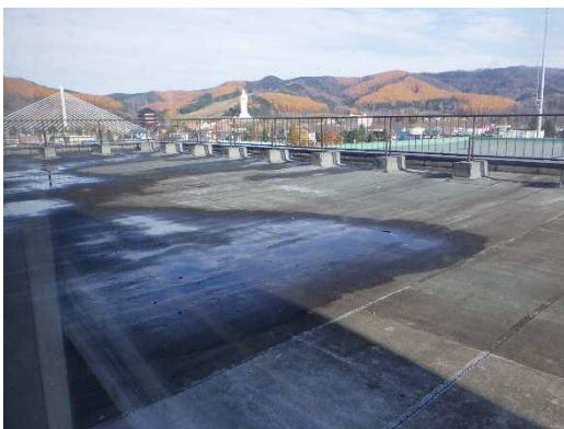
雨水が溜まる屋上防水
