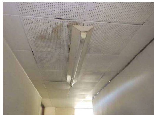
天井雨漏り跡
