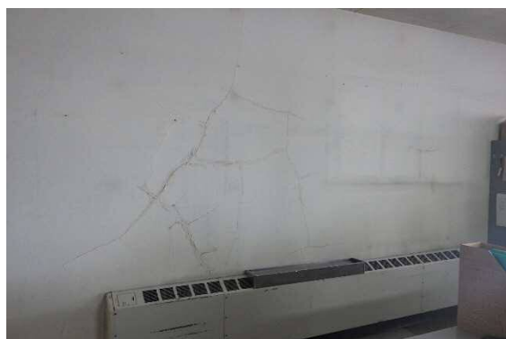
壁のクラック
