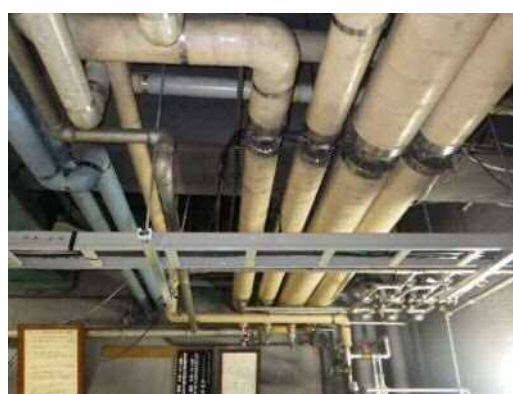
ボイラー配管の老朽
