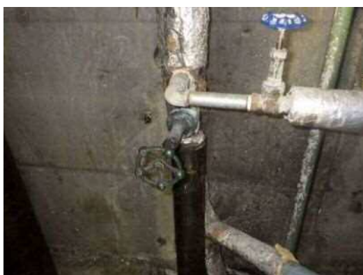
給排水管の老朽
