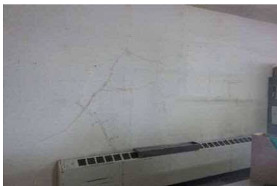
壁のクラック
