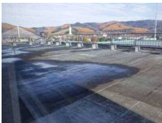
雨水が溜まる屋上防水
