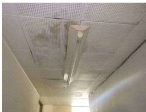
天井雨漏り跡
