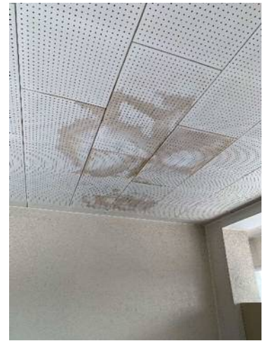
天井の雨漏り跡
