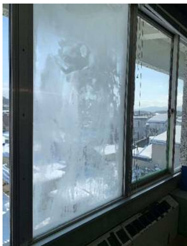
二重窓の真空機能が失われ 断熱効果が損なわれた窓
