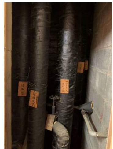
パイプシャフト空間が狭く 配管の取換えが困難な状況
