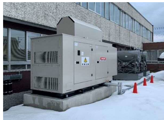
非常用発電機（市総合庁舎）
