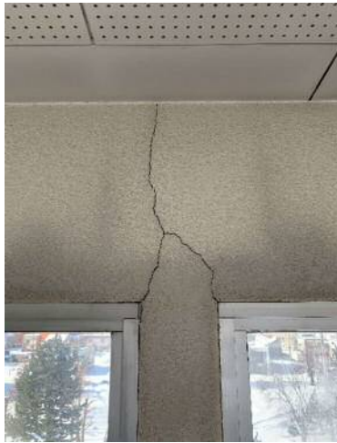
内装梁のひび割れ
