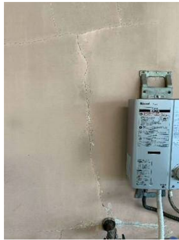
内装壁のひび割れ
