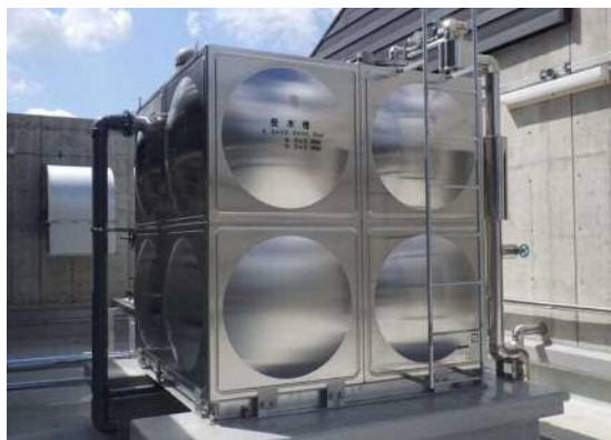
耐震貯水槽事例（岡崎市）
