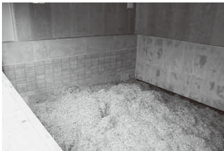
健民センター施設群に導入した木質チップボイラーのチップサイロ
