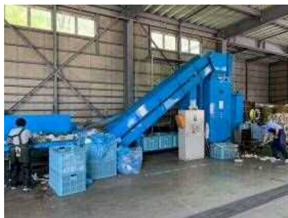
資源ごみ保管施設
